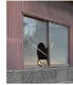
窓が割れた 管理不全空家
